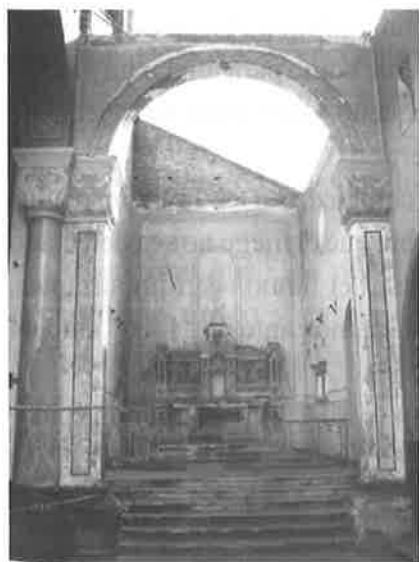
No detalhe, teto completamente destruído
